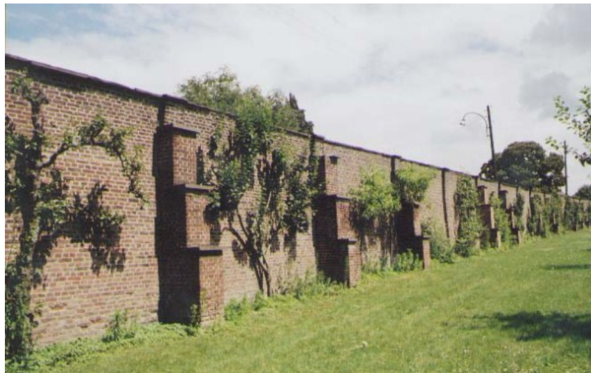
De in 1860 gebouwde muur langs de Wolvertemsesteenweg en ingericht als fruitmuur bij de Norbertijnenabdij (Deneef, Roger, 01-01-2000, ©Vlaamse Gemeenschap)
